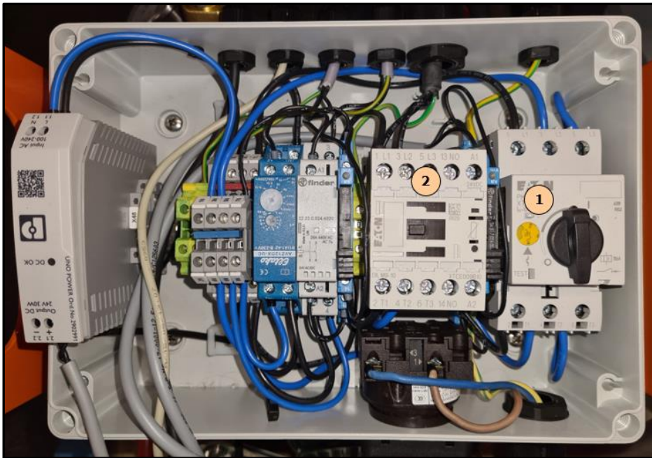
Abb. 13.1: Motorschutzschalter im Schaltkasten
